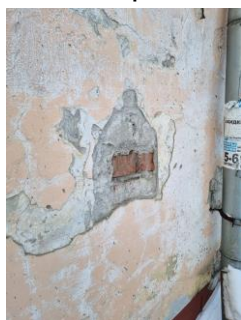
Рисунок 1 – Местное разру- шение облицов- ки
