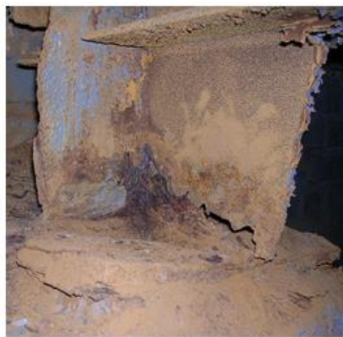
Фото 2. Сквозная коррозия опорного узла.
