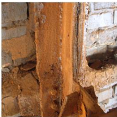
Фото 1. Скопление продуктов коррозии, деформации полков уголков.
