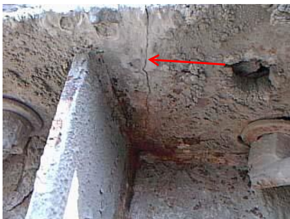
Рисунок 4 – Трещины по основному металлу опорной плиты консолей колонн
