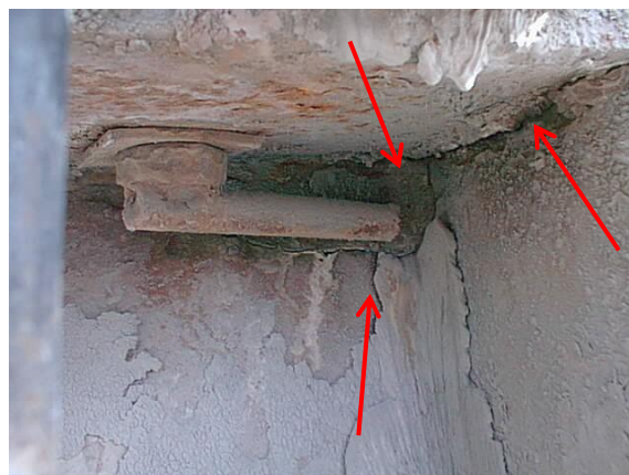
Рисунок 5 – Трещины по основному металлу стенок и в сварных швах консоли колонн
