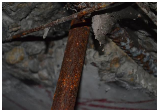
Фото 2. Неэксплуатируемые отверстия со сколами защитного слоя бетона.
