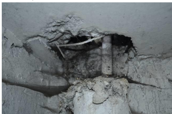
Фото 1. Конструктивно неоформленные узлы пропуска через плиты перекрытия.
