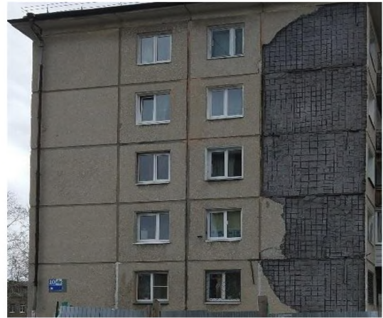
Рисунок 2 – Обрушение фактурного слоя в г. Ангарске в 10 мкр.
