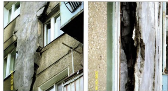
Рисунок 3 – Повреждения дома серии 1-335с в г. Иркутске на ул. Розы Люксембург, 311.
