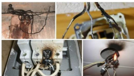
Рисунок 1 - Возможные проблемы алюминиевой электропроводки
