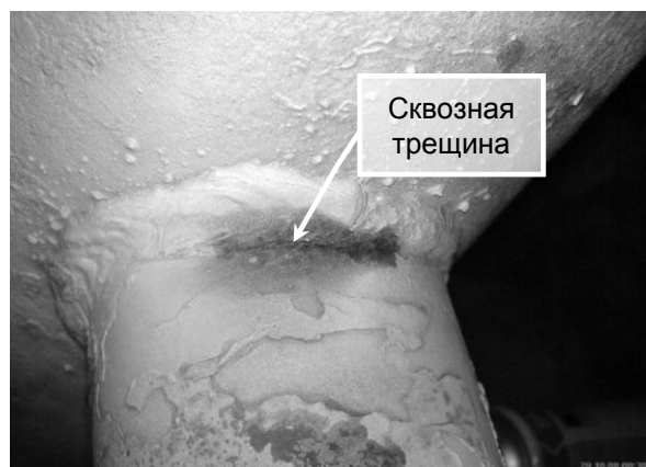
Рисунок 1 - Фрагмент врезки патрубка в обечайку со сквозной трещиной
