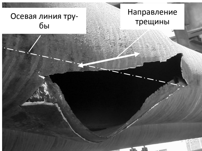
Рисунок 2 - Фрагмент технологического трубопровода в зоне разрушения стенки
