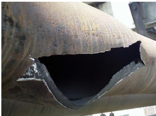
Рисунок 5 - Фрагмент технологического трубопровода диаметром 250 мм с трещиной в зоне расслоения металла стенки
