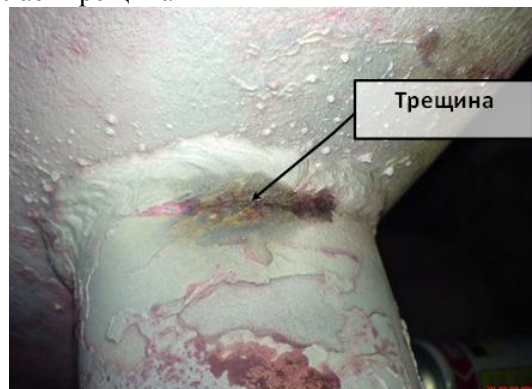
Рисунок 4 - Фрагмент сварного шва приварки патрубка к обечайке с трещиной
