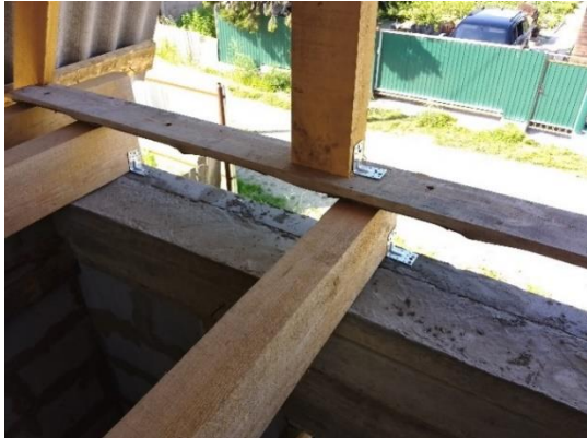
Рисунок 1 – Отсутствует обвязка элементов.
