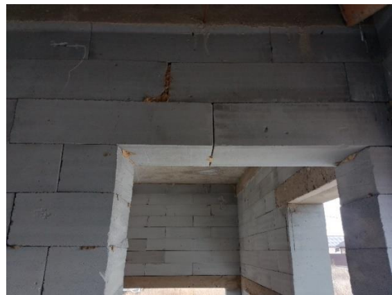
Рисунок 2 – Отсутствуют перемычки дверных проемов.
