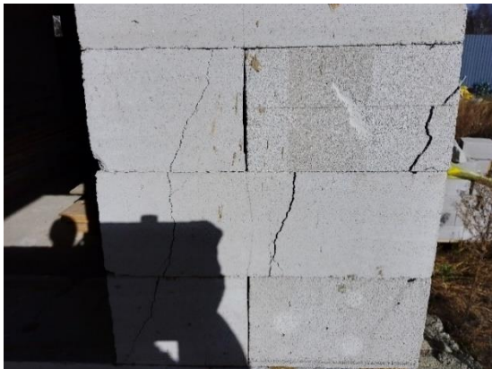
Рисунок 1 – Сквозные трещины в несущих стенах.
