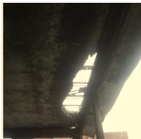
Рисунок 2 – Разрушение тела плиты
