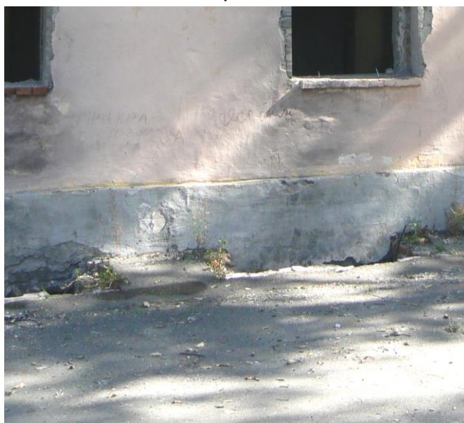
Рисунок 3 – Разрушение отделочных слоёв стенок прямка
