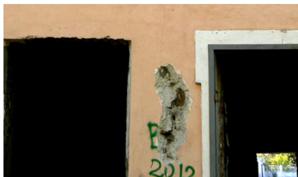
Рисунок 2 – Трещины в стенах здания, проходящие по швам кладки
