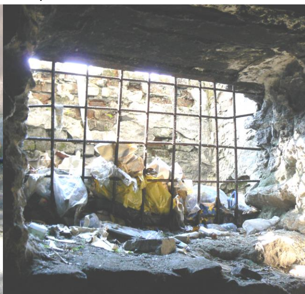
Рисунок 4 – Разрушение отделочных слоёв стенок прямка, замусоривание
