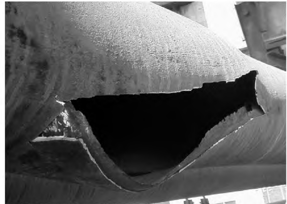
Рисунок 2 - Фрагмент технологического трубопровода диаметром 250 мм с трещиной в зоне расслоения стенки Рисунок 1 - Фрагмент сварного шва приварки
